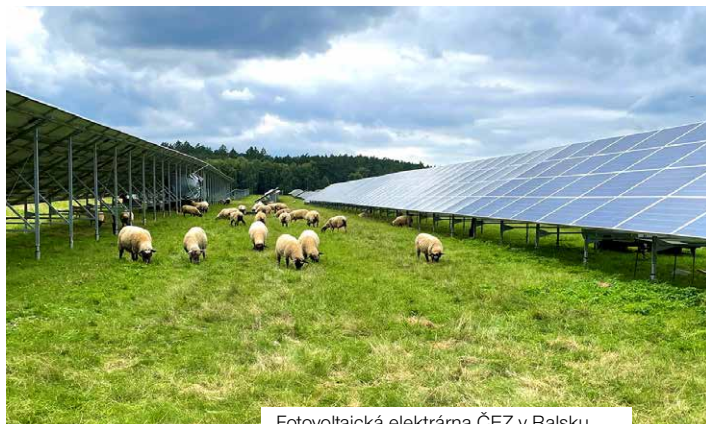
Fotovoltaická elektrárna ČEZ v Ralsku
