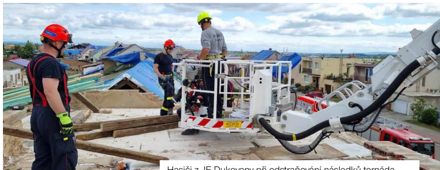
Hasiči z JE Dukovany při odstraňování následků tornáda
