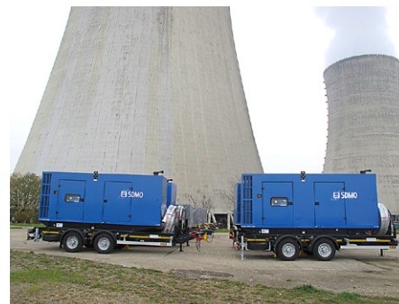
Pod chladicími věžemi elektrárny čekají dieselgenerátory i kabelové vozy na své konečné rozmístění
