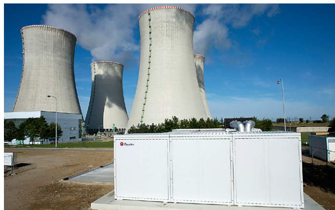
Osazený kontejner s dieselgenerátorem na západní straně elektrárny
